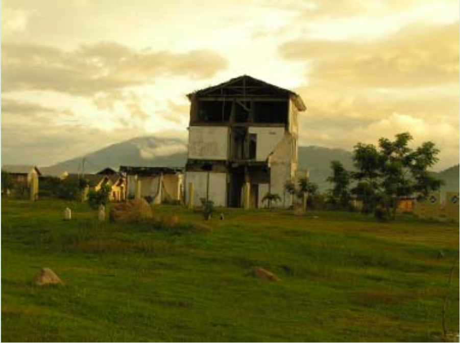
Gambar 9.1. Kerusakan akibat tsunami di Banda Aceh, Sumatera. Sumber foto: Pieter van Eijk.
